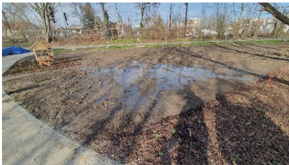
Rysunek 39 Problem z odwodnieniem – stan na 15 marca 2024 roku.
